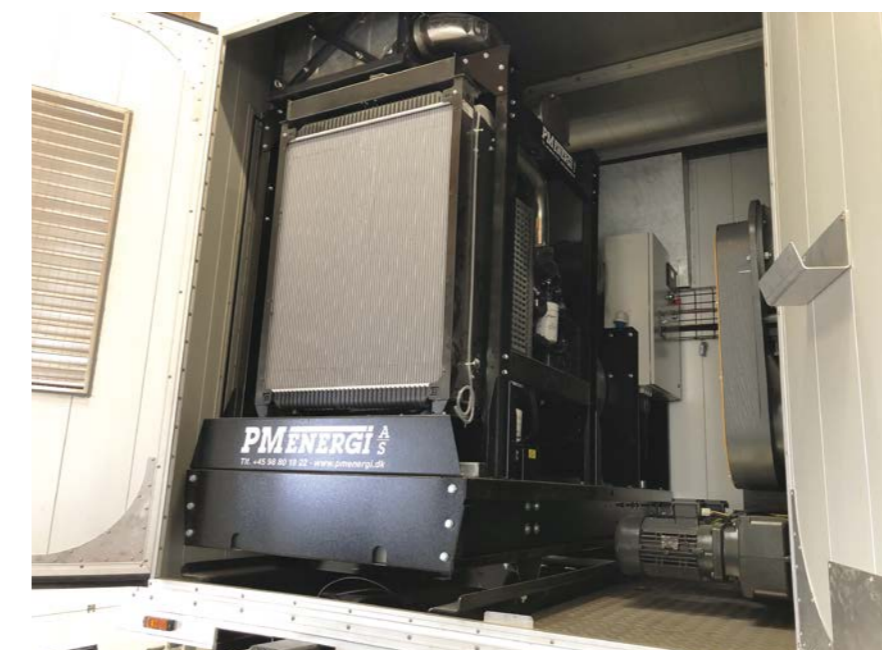
Maschinenraum mit Dieselgenerator und Hydraulikstation.
